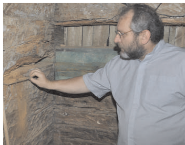
Spróchniałe belki ciany północnej
